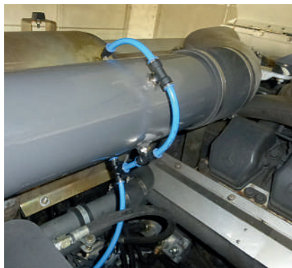
Ringmessleitung an der Luftführung misst Differenzdruck nach dem Filter.
