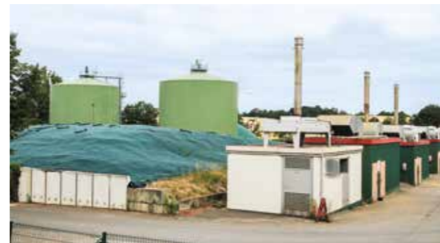
Die Biogasanlage, deren Abwärme die Fischproduktion und -verarbeitung möglich macht, steht einige Hundert Meter entfernt.
